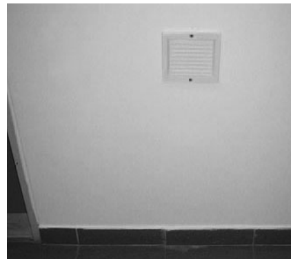
Obr. 5 Demontovatelná mřížka zakrývající výklenek s prívzdušňovacím ventilem
