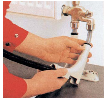
6. Pripojenie rúrky na vykurovacie teleso (na obr. cez jednorúrkovú armatúru pomocou adaptérov).
