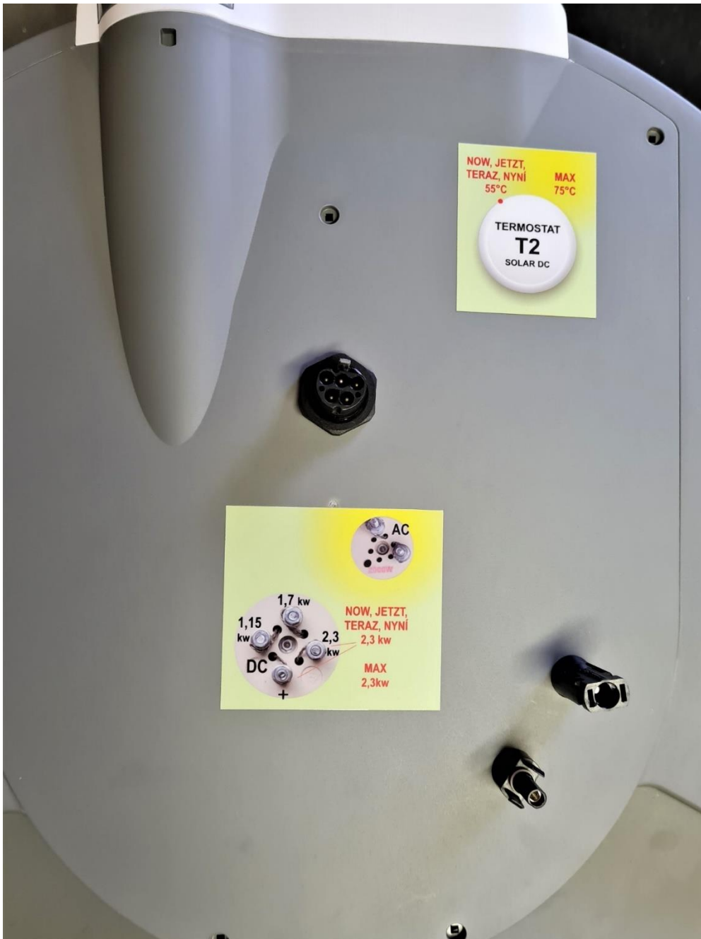
Obr.č.4 Plastový kryt elektroinštalácie umiestnený na spodnej časti zásobníka vody
